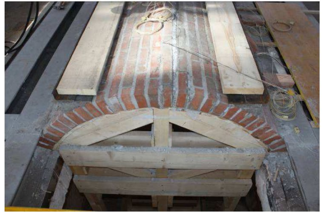
26/5/2015 – figura 43 Sistema di ripartizione del carico concentrato (profilo a L, piatto in acciaio e tavolone di legno)
