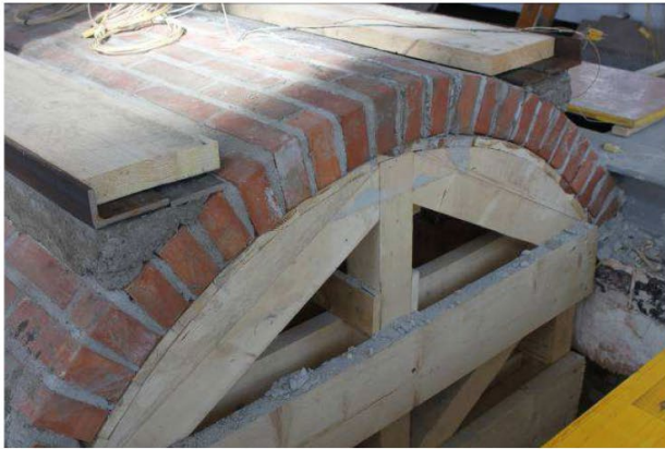
26/5/2015 – figura 42 Sistema di ripartizione del carico concentrato (profilo a L, piatto in acciaio e tavolone di legno)
