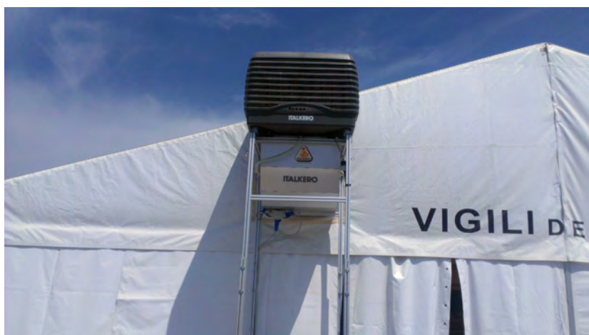
Foto 2: Particolare unità di condizionamento
