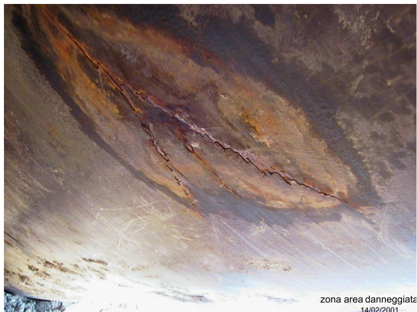
Fotografia n° 4 – Particolare cricca dall'esterno del serbatoio
