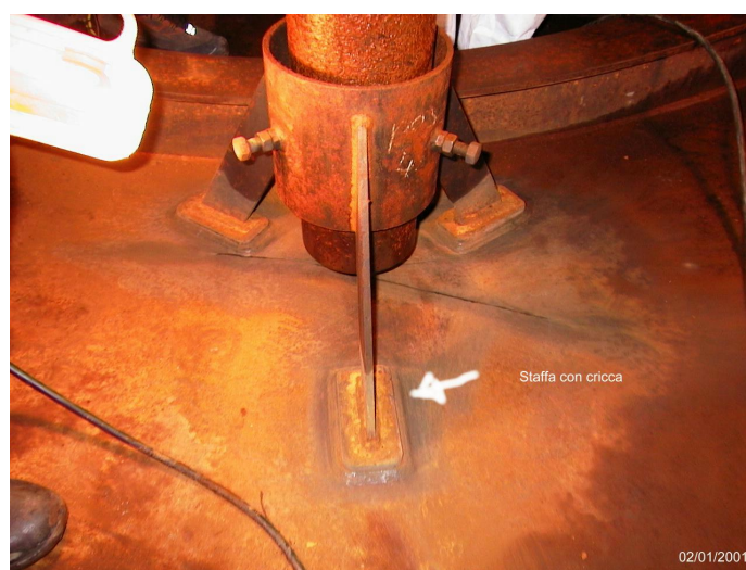
Fotografia n° 3 – Particolare cricca dall'interno del serbatoio
