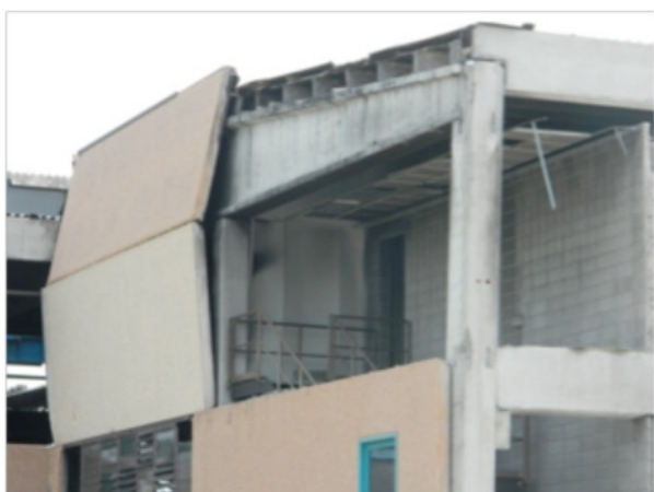
Figura 10 – Distacco dei pannelli di tamponatura
