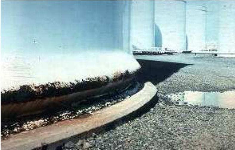
Figura 6 – danneggiamento serbatoio a “piede di elefante”
