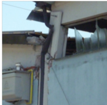
Figura 7 – danni alle colonne
