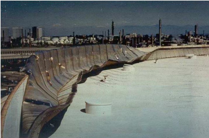
Figura 7 – Danni alla copertura di un serbatoio
