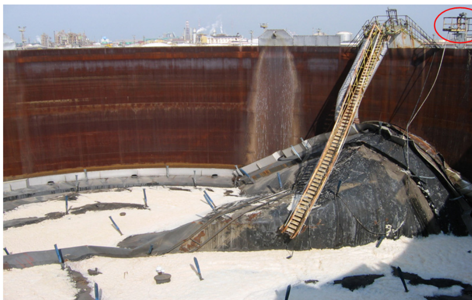
Fig. 2 Stato del tetto del serbatoio DA1305
