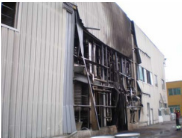
Figura 3. esterno del reparto dopo l'esplosione
