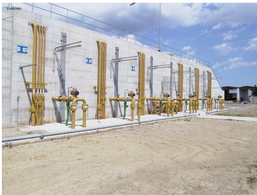
Fotografia n° 2 – Tumulo e tubazioni zona stoccaggio
