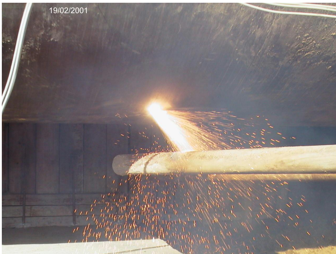
Fotografia n° 5 – Operazione prelievo parte danneggiata
