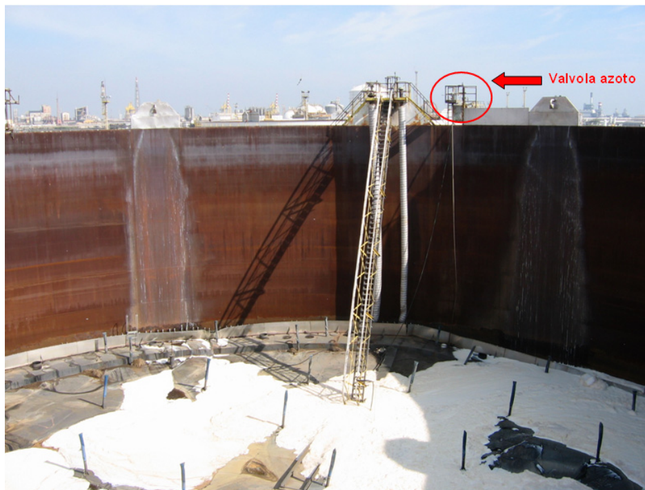
Fig.3 Stato del tetto del serbatoio DA1306
