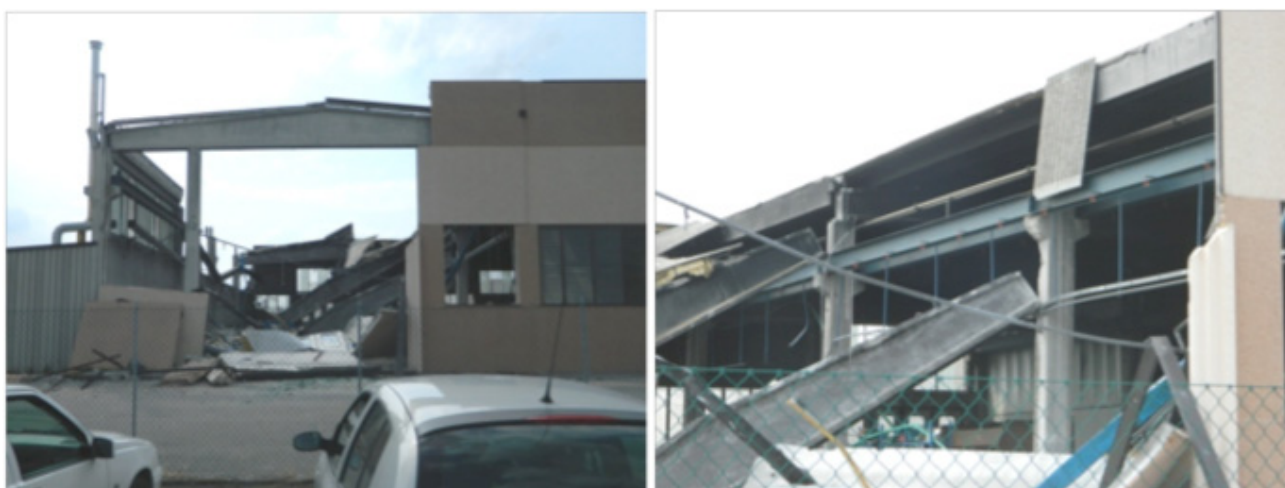
Figure 3, 4 – Danni a stabilimenti produttivi in Emilia Romagna
