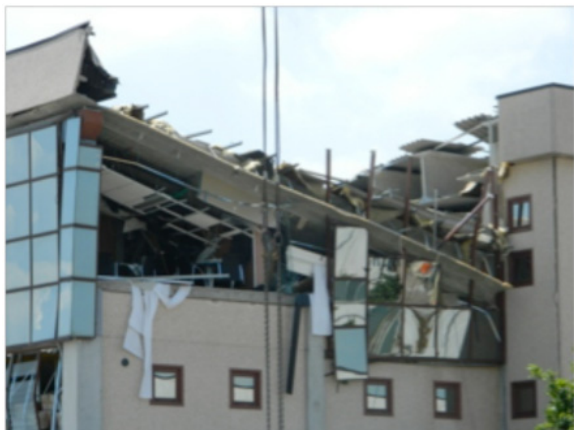
Figura 6 – Scivolamento laterale delle travi della copertura
