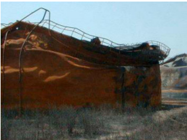
Figura 9 - Terremoto Kocaeli (Turchia) del 1999 - raffineria Yarimca
